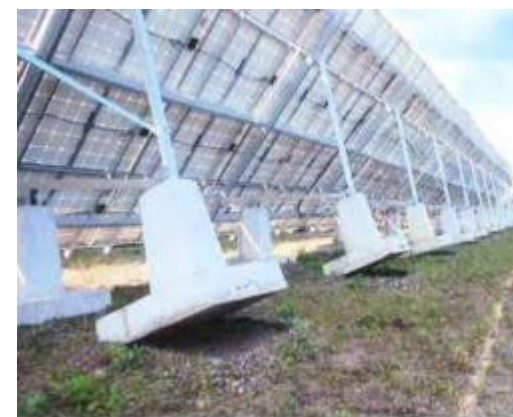
強風で架台が持ち上がり傾き
