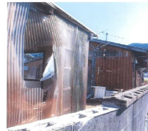
破損した民家
