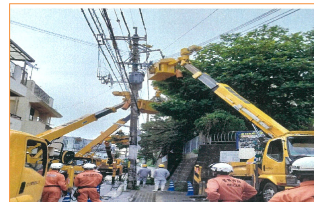
倒れた樹木が配電線と引き込み柱に接触
