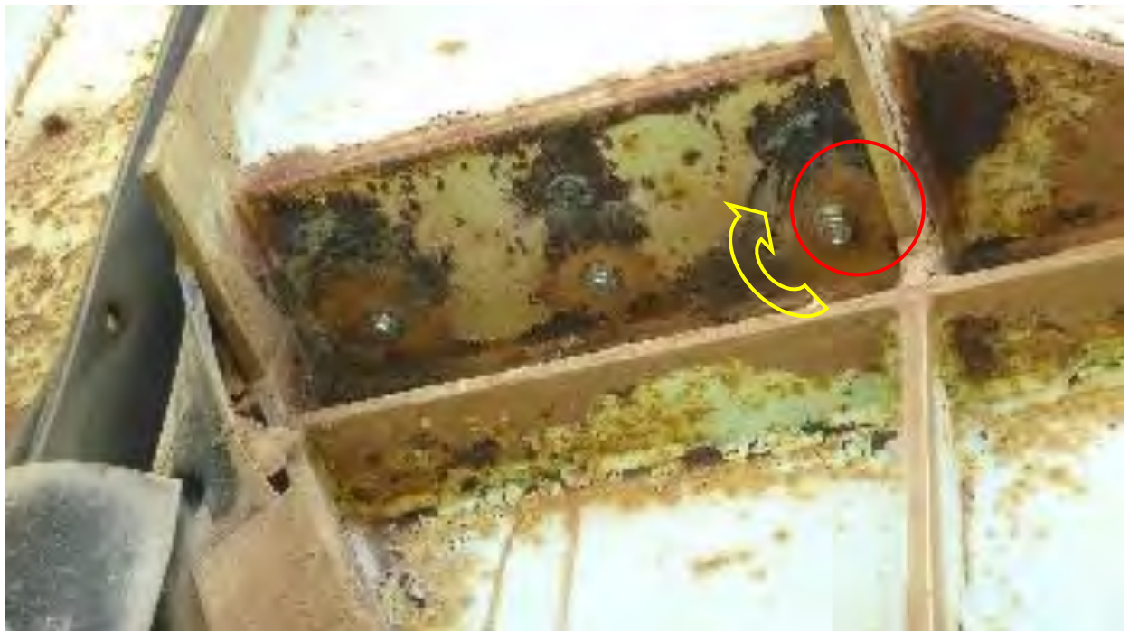
写真5：シュート左のライナー取り付けボルトナット3本（シュート外側の下から撮影）
