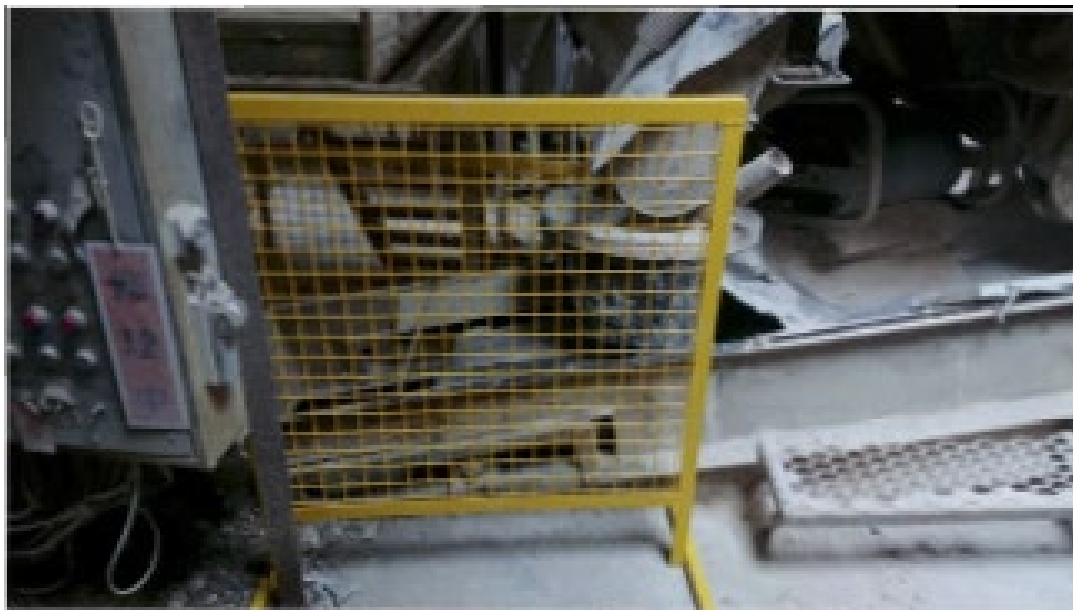
対策2:ベルトコンベア作業側へ囲いの設置
