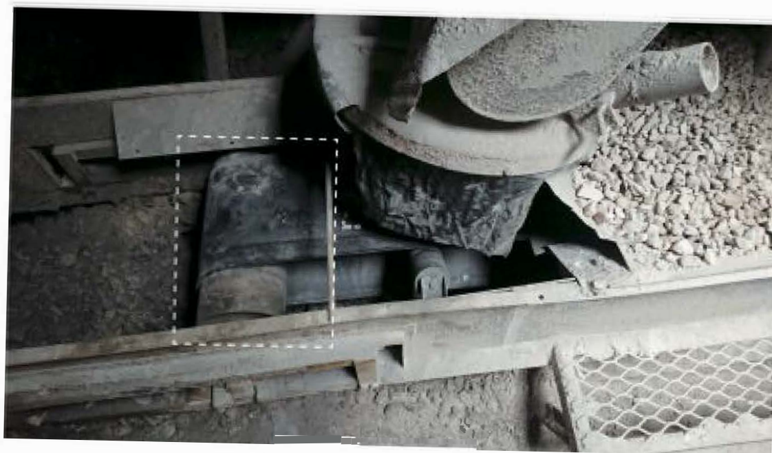
罹災現場(No.1 ベルトコンベア)
